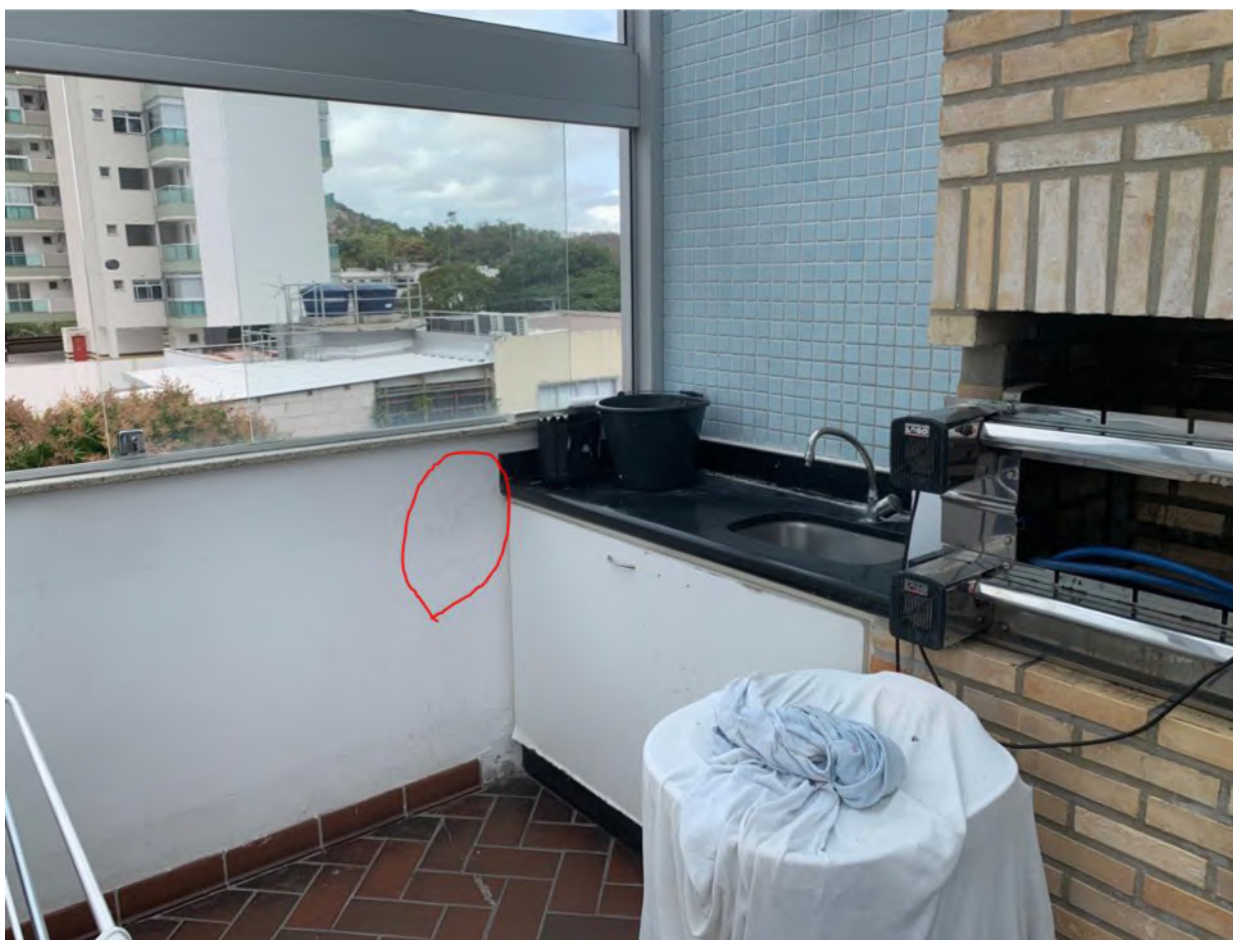
Figura 3 - Foram encontradas anomalias (fissuras, trincas e rachaduras) embaixo da janela conforme demarcado em vermelho. Necessário remover o reboco para verificação visual de possíveis anomalias.
