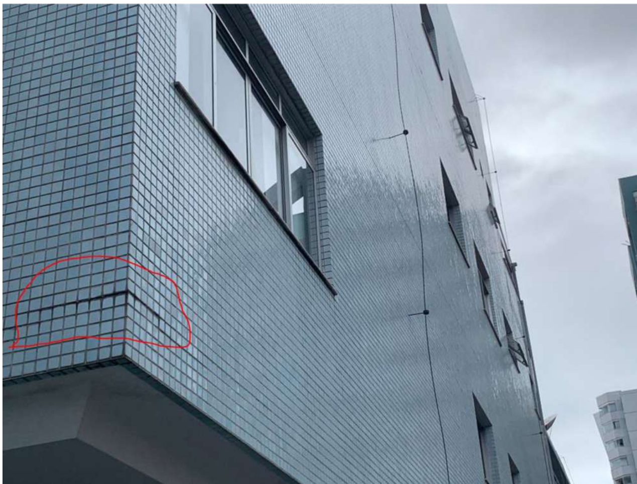
Figura 23 - Foram encontradas anomalias (fissuras, trincas e rachaduras) na fachada demarcado em vermelho. Necessário remoção do revestimento até a alvenaria para verificação visual.
