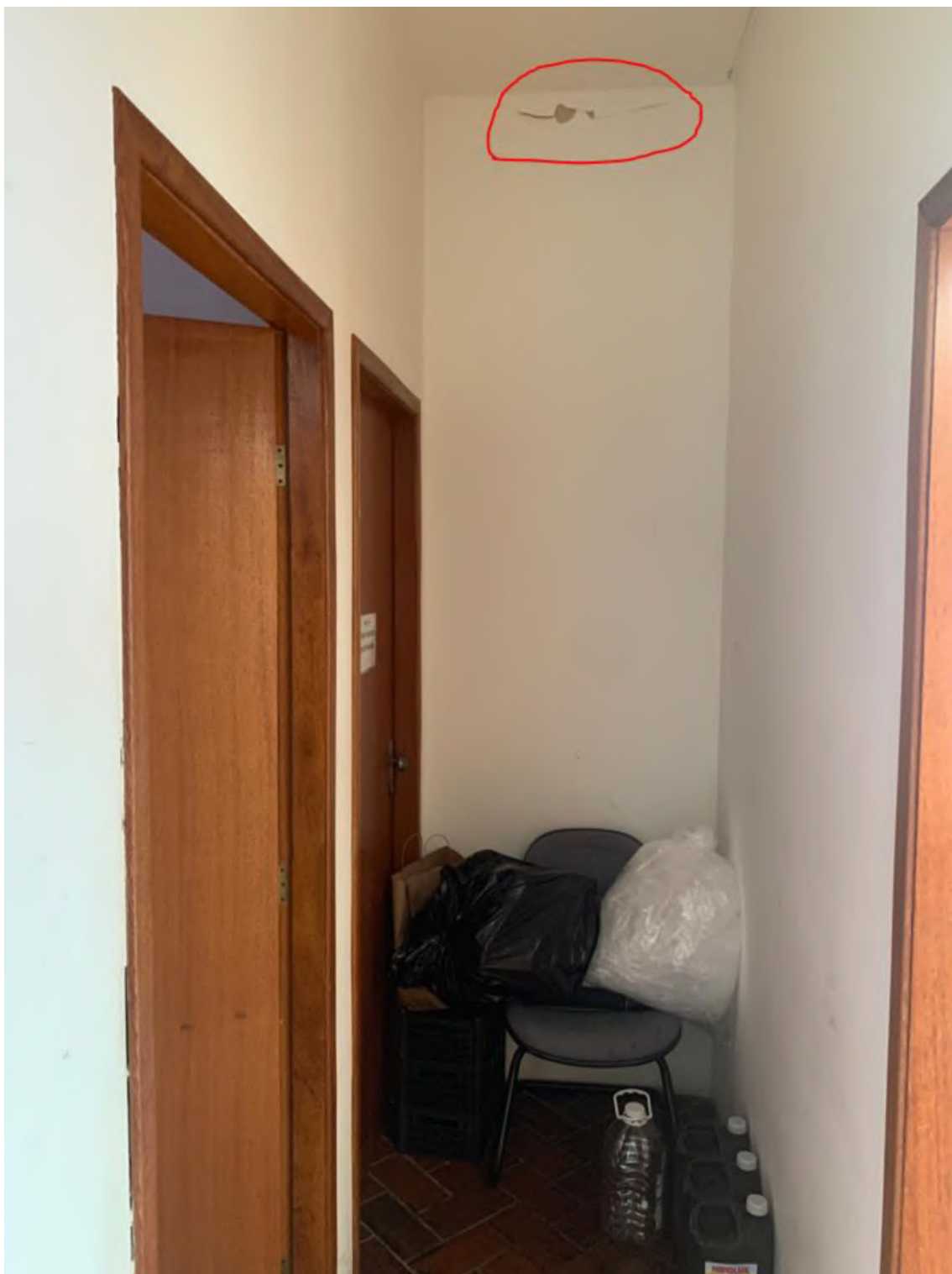
Figura 11 - Foram encontradas anomalias (fissuras, trincas e rachaduras) na parede demarcado em vermelho. Necessário remoção do revestimento até a alvenaria para verificação visual.
