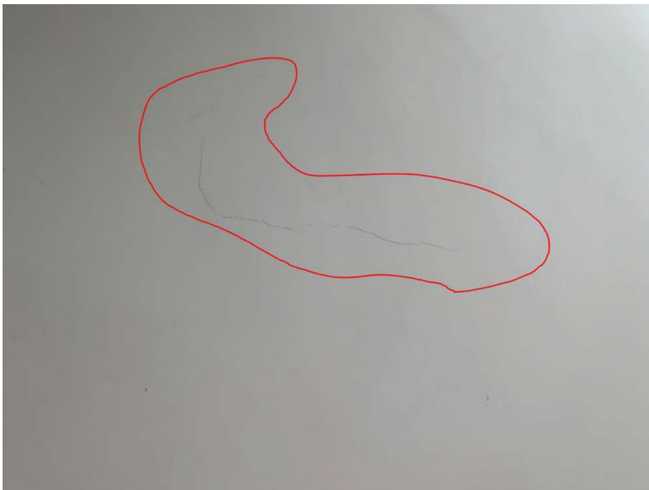
Figura 21 - Foram encontradas anomalias (fissuras, trincas e rachaduras) na parede demarcado em vermelho. Necessário remoção do revestimento até a alvenaria para verificação visual.
