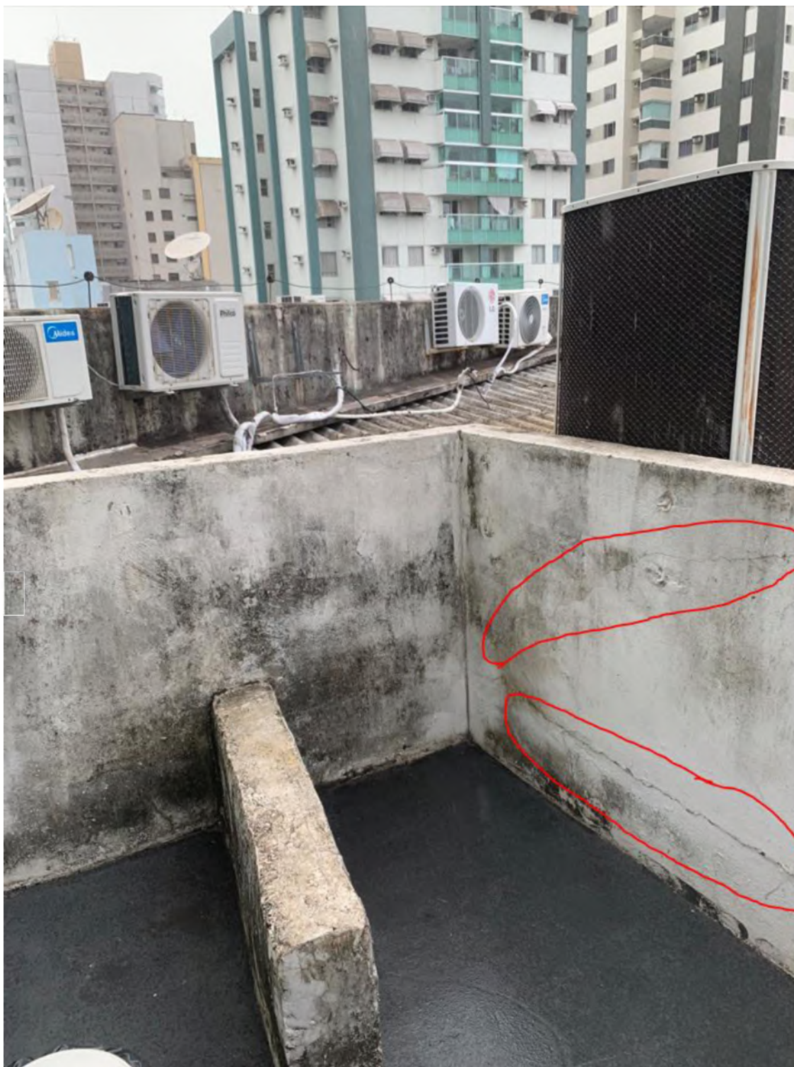
Figura 12 - Foram encontradas anomalias (fissuras, trincas e rachaduras) no parapeito demarcado em vermelho. Necessário remoção do revestimento até a alvenaria para verificação visual.
