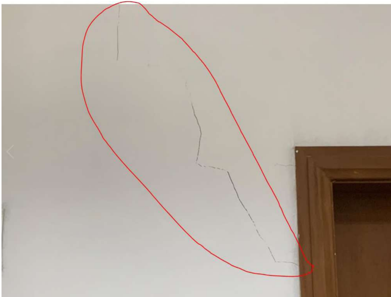
Figura 9 - Foram encontradas anomalias (fissuras, trincas e rachaduras) na parede demarcado em vermelho. Necessário remoção do revestimento até a alvenaria para verificação visual.
