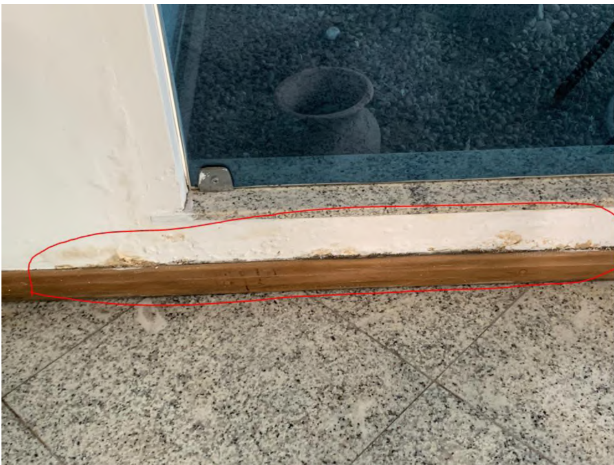
Figura 28 - Foram encontradas anomalias (fissuras, trincas e rachaduras) demarcado em vermelho. Necessário remoção do revestimento até a alvenaria para verificação visual.
