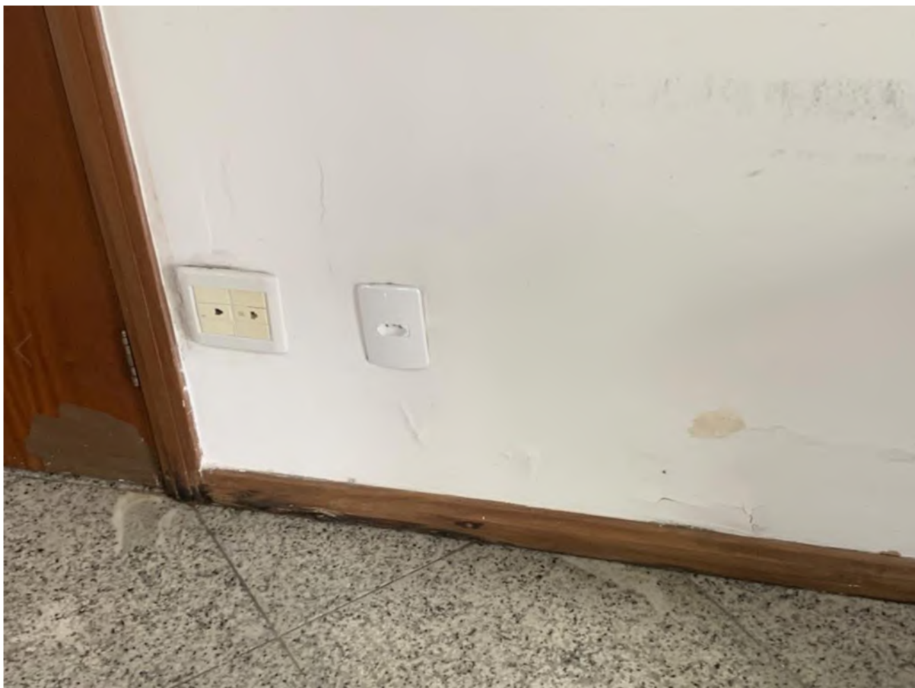
Figura 31 - Foram encontradas anomalias (fissuras, trincas e rachaduras) demarcado em vermelho. Necessário remoção do revestimento até a alvenaria para verificação visual.
