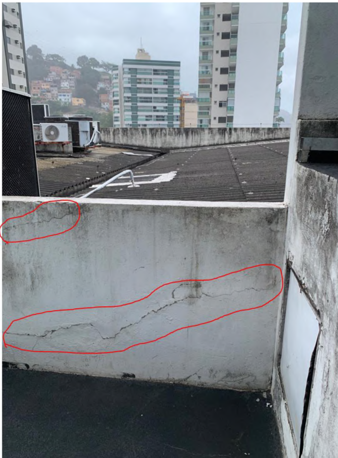
Figura 13 - Foram encontradas anomalias (fissuras, trincas e rachaduras) no parapeito demarcado em vermelho. Necessário remoção do revestimento até a alvenaria para verificação visual.
