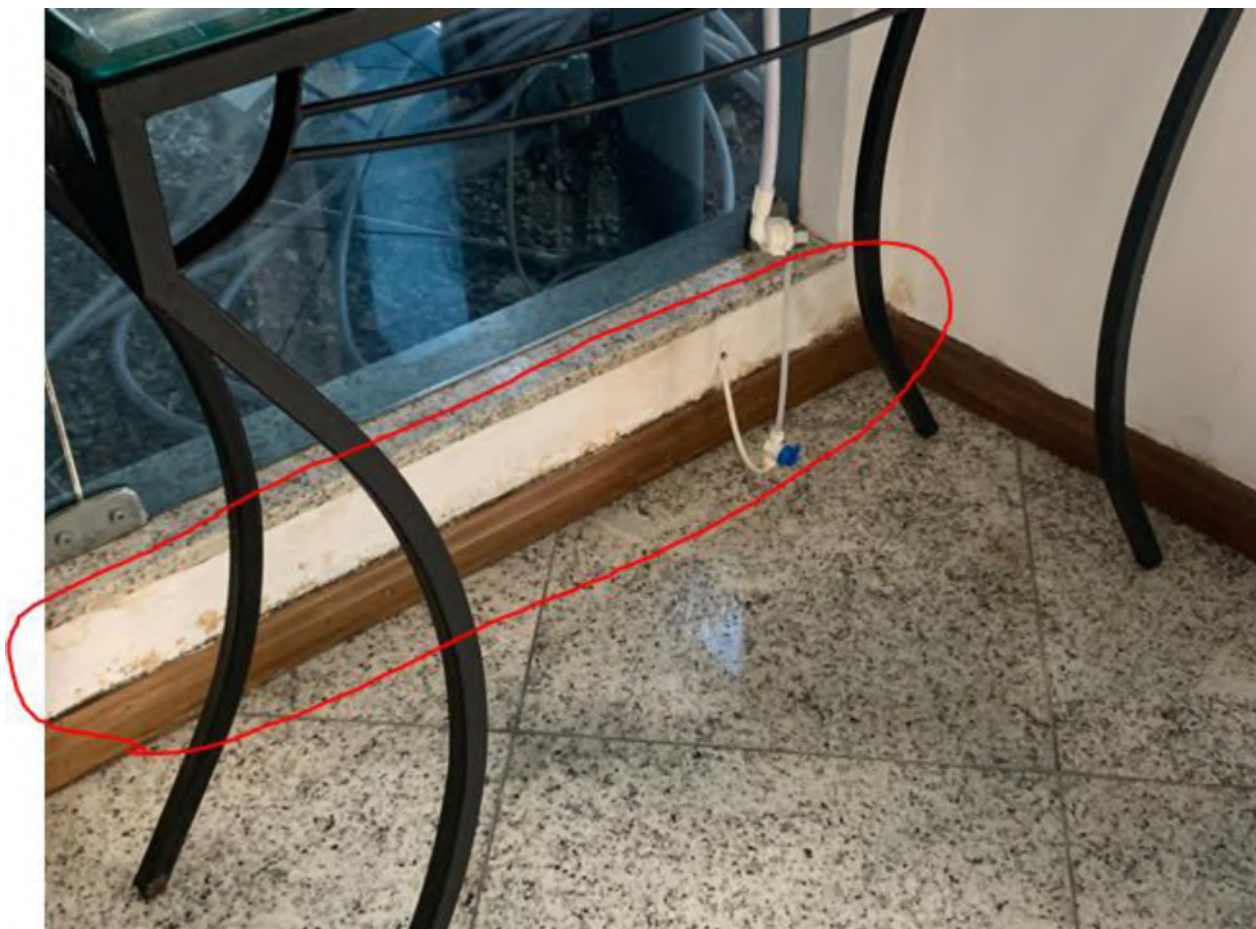
Figura 29 - Foram encontradas anomalias (fissuras, trincas e rachaduras) demarcado em vermelho. Necessário remoção do revestimento até a alvenaria para verificação visual.
